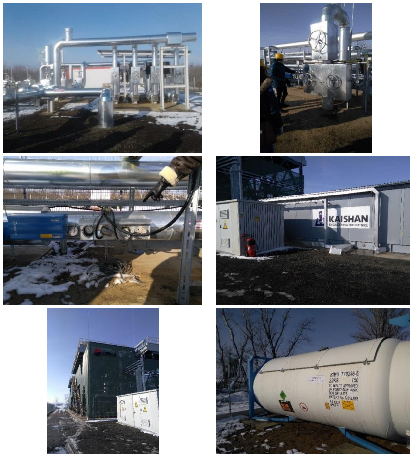
5. ábra: Helyszíni bejáráson készült fotók –visszasajtoló állomás, termelő kút, nyomás és hőmérsékletmérő berendezés a termelőkútnál, hőközpont mérnöki állomás, hőtermelő egység, munkafolyadék tároló tartály, 2018 Tura (saját fotók)
